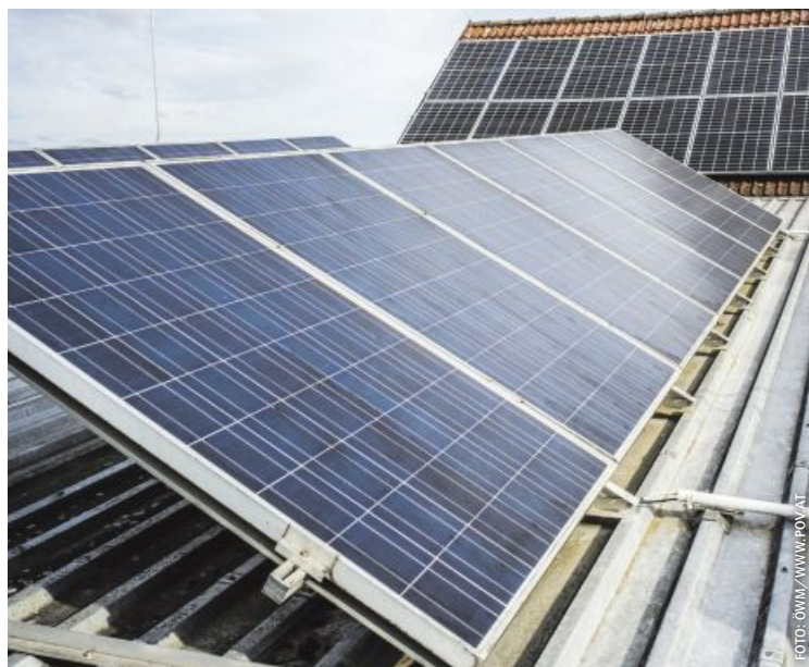
PV-Anlage auf dem Dach eines Weinguts: ein Beitrag zur Nachhaltigkeit.
