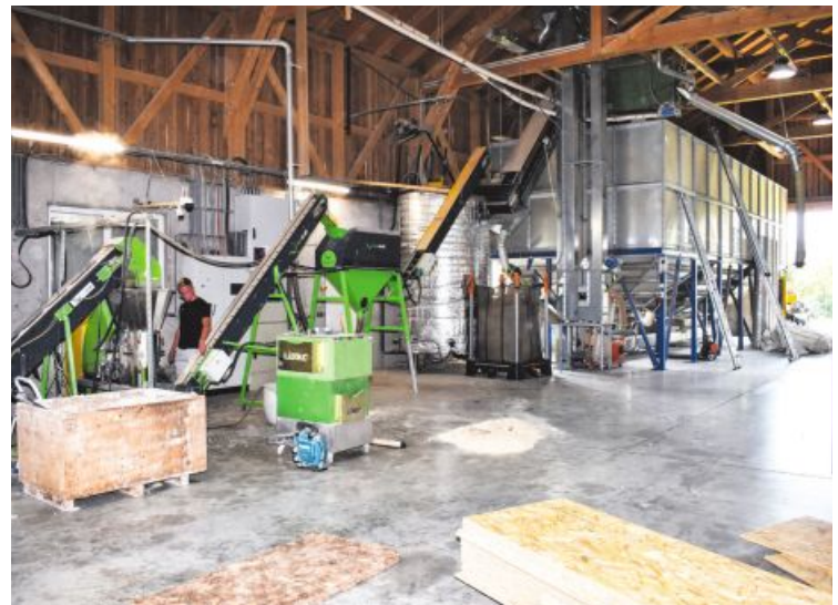
Die automatisierte Pelletieranlage in einer gepachteten, modernisierten Halle läuft von Montag bis Freitag, jeweils zwölf bis 14 Stunden lang.
