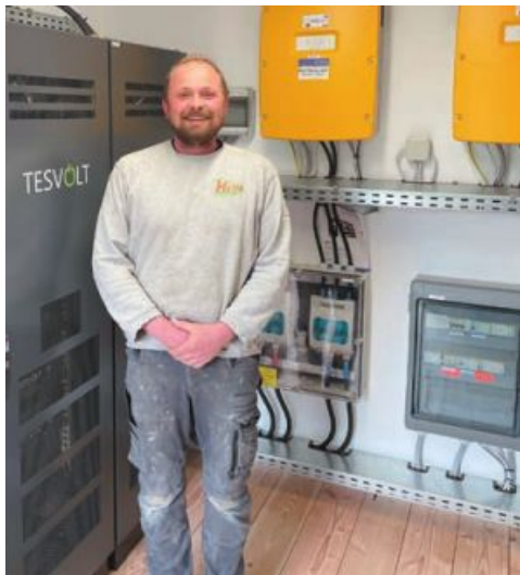
Schafflerhof-Betriebsführer Hannes Arnold ist zufrieden mit seiner Stromspeicher-Anlage.
