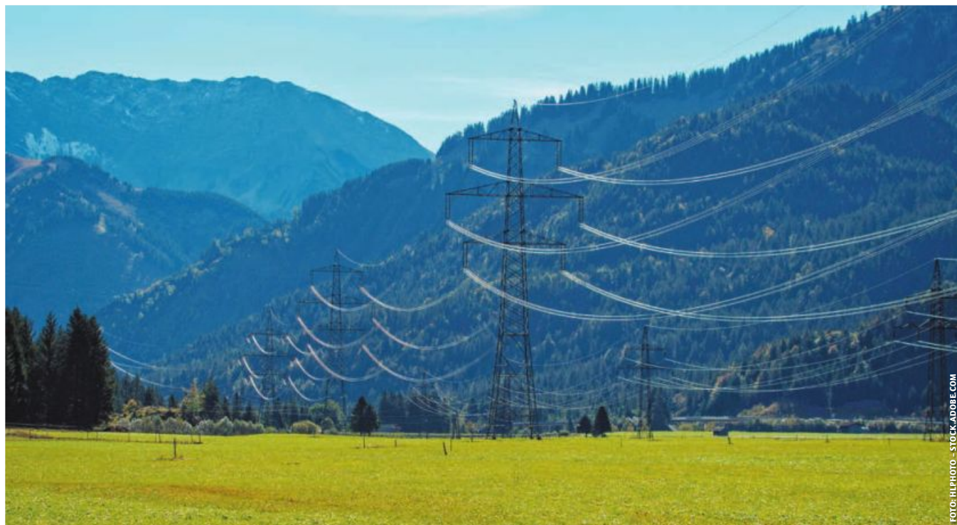
Die Verteilernetze spielen eine große Rolle bei der Erreichung der Energie- und Klimaziele.
