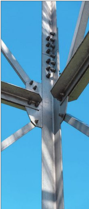
Stahl ist sehr langlebig, wenn es vor Korrosion geschützt wird, tragfähig und elastisch.
