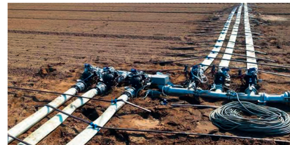
Verteilnetz einer Tropfbewässerung. Die richtige Dimensionierung der Anlage ist entscheidend für die Wirtschaftlichkeit.
